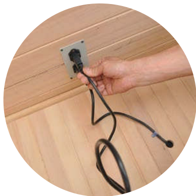
Zapojené kabely topidel
